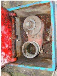
Bouche Incendie de 80 mm à raccord Keyser
