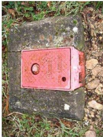
Bouche de lavage fermée
