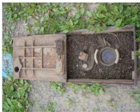
Bouche Incendie de 80 mm à tenons
