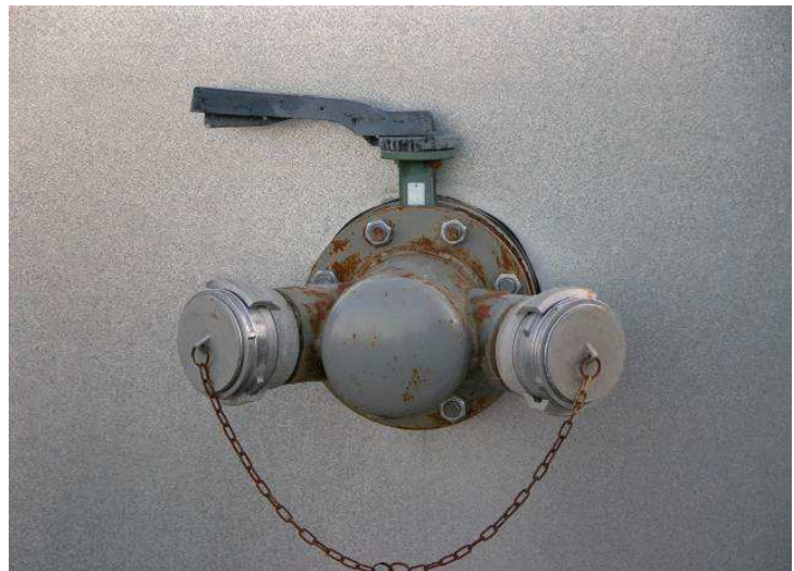
Prises directes de 100 mm sur réserve d'eau incendie aérienne
