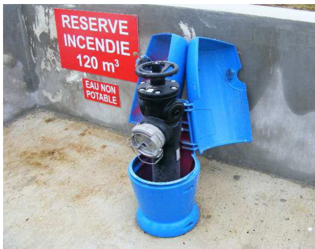
Poteau d'aspiration de 100 mm, muni d'une seule sortie de 100 mm et d'un volant de manœuvre
