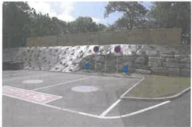
2 Plates formes d'aspiration sur une réserve d'eau équipée de deux poteaux d'aspiration de 150 mm
