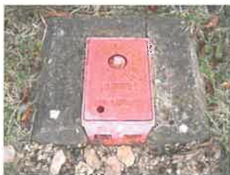
Bouche de lavage fermée
