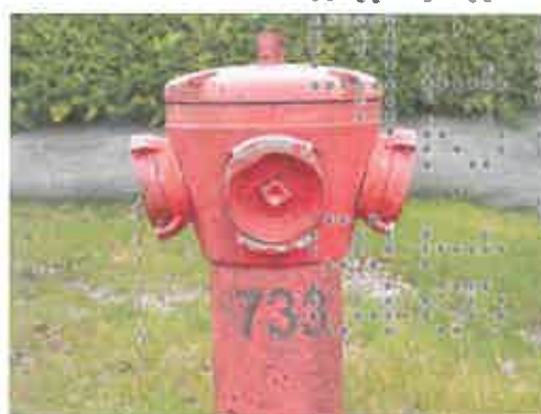
Poteau Incendie de 150 mm avec trois sorties de 100 mm
