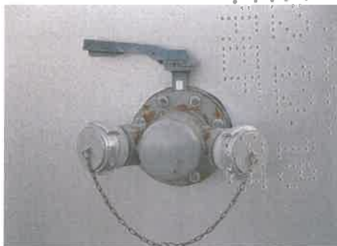
Prises directes de 100 mm sur réserve d'eau incendie aérienne
