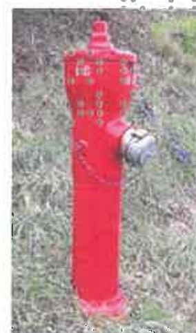
Poteau incendie de 80mm avec une sortie de 65mm
