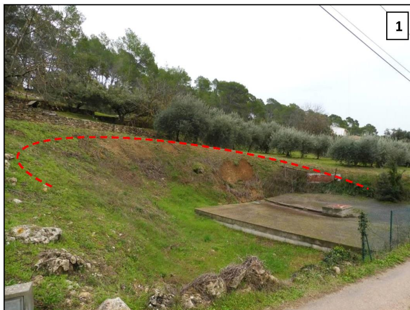
Figure 6. Effondrement récent rue Casteou Rignadou
