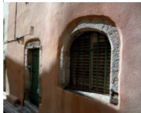
Mise en œuvre d'enduit inappropriée
