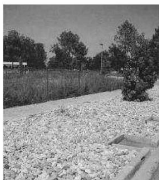
Tranchée sous-trottoir Av de la Grande Lande - GRADIGNAN - 33 Source CETE du Sud-Ouest.
