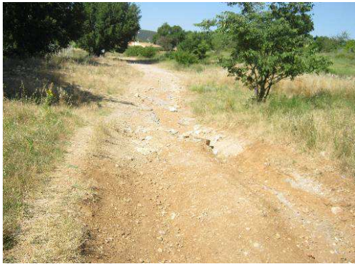
Photos 103 : Vallon Sainte Barthe : Secteur Sainte Barthe
