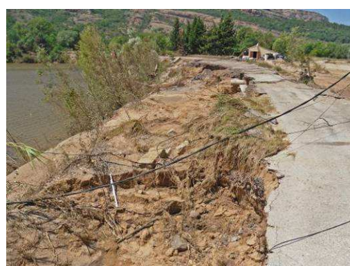
Photos 25 : L'Argens à Roquebrune Dégradation de la chaussée à l'amont du lac de l'Aréna - Post crue
