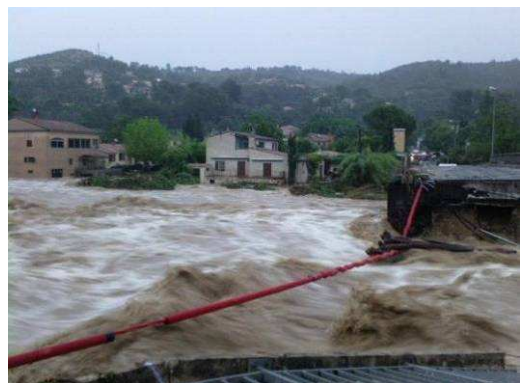
Photos 35 : La Florièze à Taradeau : Pont de la RD 10 emporté
