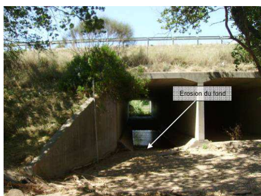
Photos 24 : Passage inferieur sous l'A8 à Roquebrune - trace d'érosion et de mises en vitesses - Source EGIS eau
