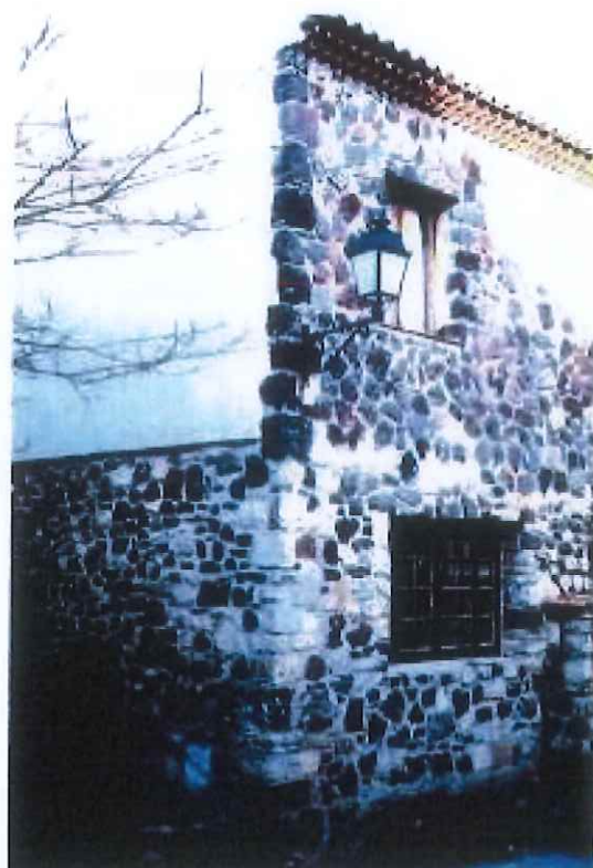
2-Rénovation partielle (problème raccord enduit appareillage de pierre)
