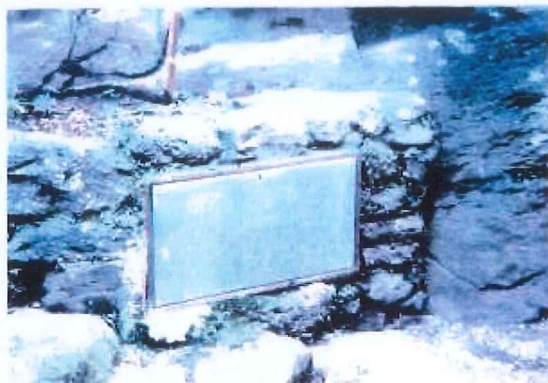
Compteur encastré mais façade peu esthétique
