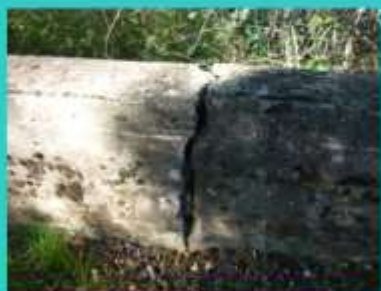
Busage dégradé de la RD70 (pk 19.9)
