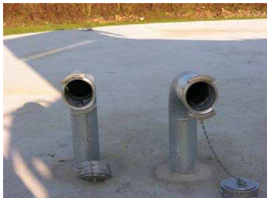
Deux colonnes d'aspiration de 100 mm sur une réserve d'eau enterrée
