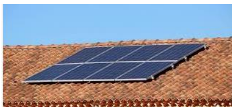
↑ Autorisé : Panneaux en surimposition parallèlement à la toiture
