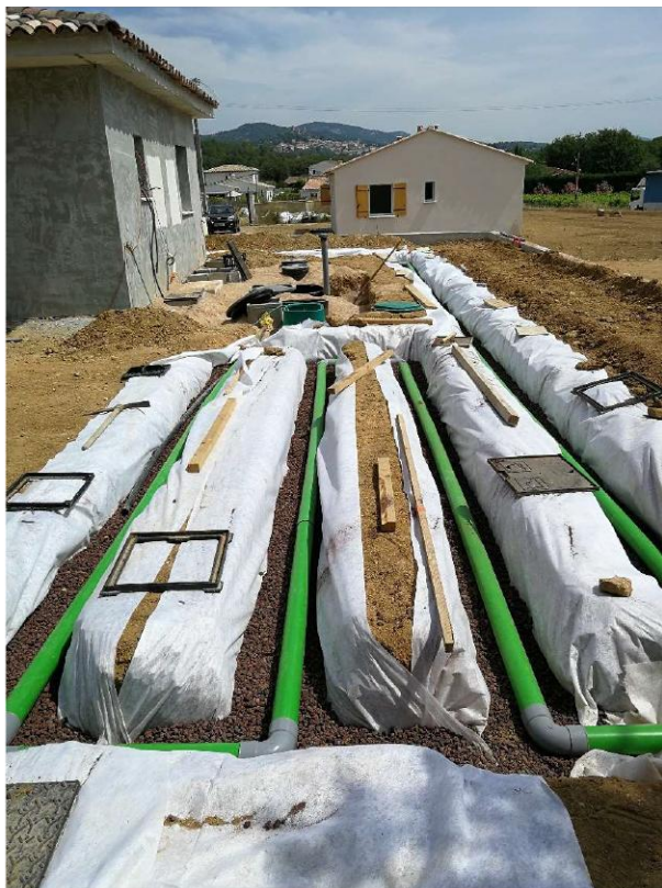
Installation d'assainissement non collectif
