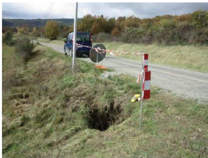
Effondrement localisé, novembre 2015 RD16 commune de Sigonce © GEODERIS
