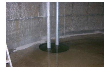
Fond de la cuve avec crépine sous le niveau le plus bas de l'eau
