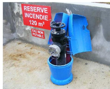
Poteau d'aspiration de 100 mm, muni d'une seule sortie de 100 mm et d'un volant de manœuvre
