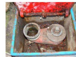
Bouche Incendie de 80 mm à raccord Keyser
