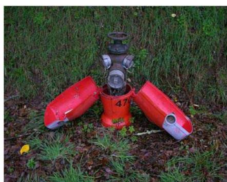
Poteau Incendie de 100 mm avec une sortie de 100 mm et deux sorties de 65 mm
