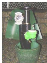
Intérieur d'une borne de puisage avec 1/4 raccord de 65 mm et compteur d'eau
