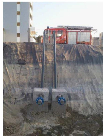
Deux colonnes de 100 mm sur une réserve d'eau
