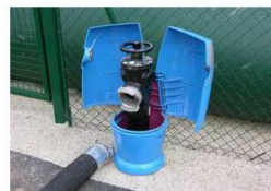
Poteau d'aspiration de 100 mm
