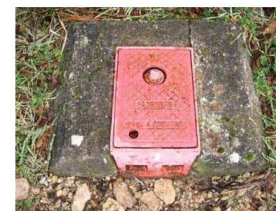
Bouche de lavage fermée
