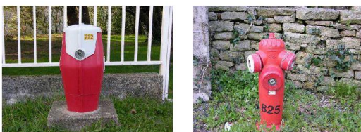
Exemples de numérotation de poteaux incendie
