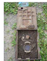
Bouche Incendie de 80 mm à tenons
