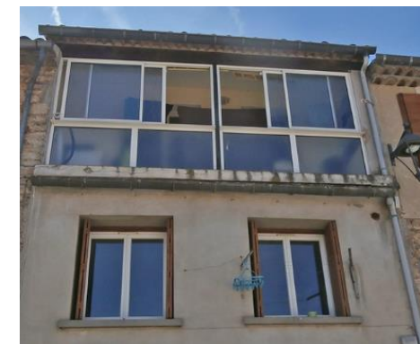
Exemple de loge en attique à ne pas suivre.
