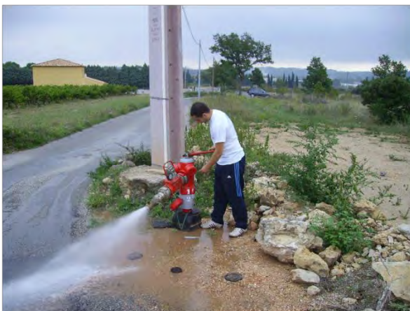
Photo : test d'un poteau incendie sur la conduite fonte Ø150 alimentée depuis le réservoir de Pey gros, à proximité de la station des Angles.
