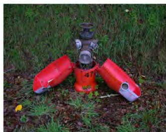
Poteau Incendie de 100 mm avec une sortie de 100 mm et deux sorties de 65 mm
