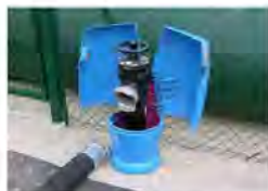
Poteau d'aspiration de 100 mm
