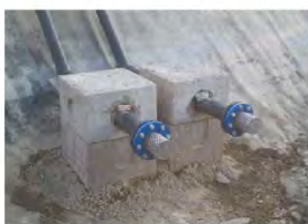
Espace libre tout autour des crépines pour éviter leur obstruction
