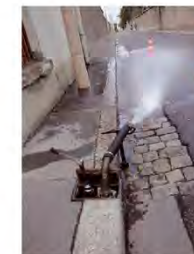
Bouche de lavage utilisée avec un « col de cygne »
