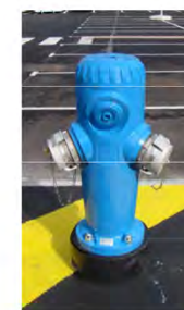
Poteau d'aspiration à réseau sec de 150 mm, muni de deux sorties de 100 mm et d'un Airclap. Pas de carré ni de volant de manœuvre
