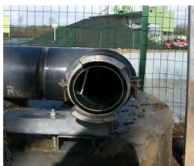
Une sortie de 100 mm avec les tenons verticaux (l'un au dessus de l'autre)
