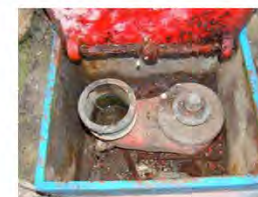
Bouche Incendie de 80 mm à raccord Keyser
