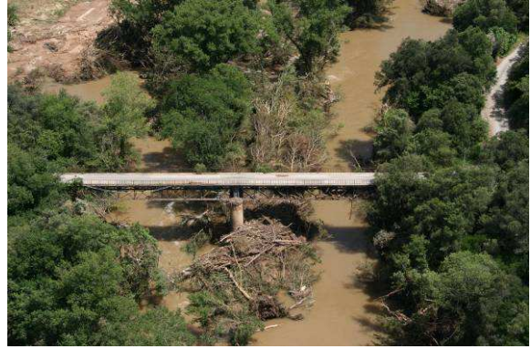
Photos 11 : Pont de l'Aille – Gorges de l'Argens en aval des Arcs – Post crue
