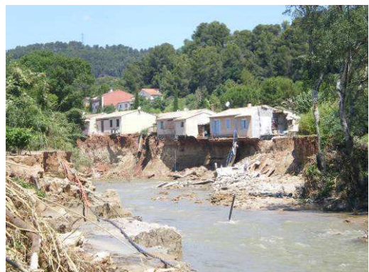
Photos 126 : Aval de La Motte – Érosion et mise en péril du Lotissement les hauts de la Nartuby
