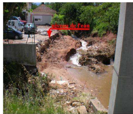
Photos 49 : Le Sainte Cécile au niveau de la caserne des Pompiers des Arcs - Post crue
