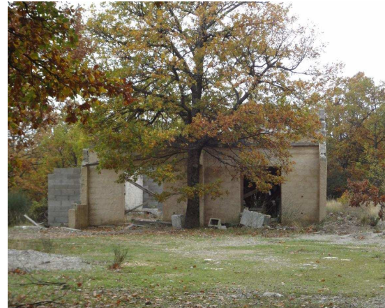
Bâti délabré en bordure de site
