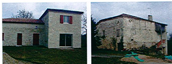
Disparité de l'état du bâti traditionnel : réhabilitation du bâti dans le respect des valeurs architecturales et exemple de délabrement
