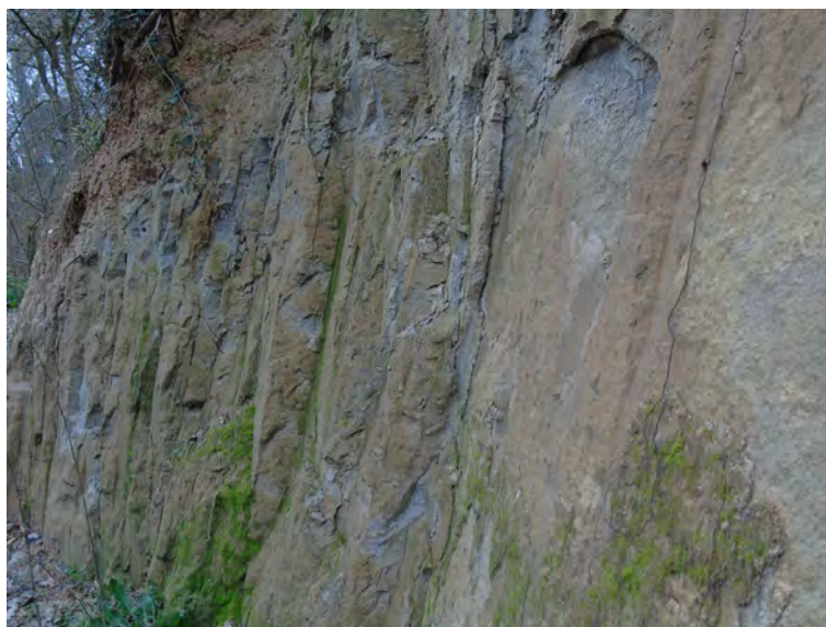
Figure 8: Détail de l'affleurement de molasses sableuses de Lagrave. Noter l'érosion superficielle par desquamation de lames décimétriques.
