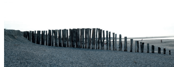
Épis transversaux en bois - LMA.
