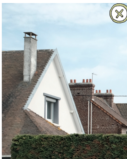
Souches de cheminées en béton : appauvrissement du détail et du paysage urbain.
