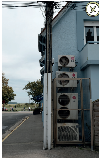
Les postes extérieurs sont nombreux et entourés d'une grille de protection. L'ensemble très technique et déqualifiant.
