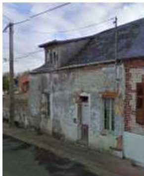
Logement vacant dégradé
