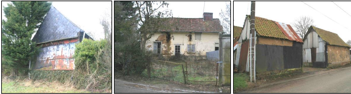
Exemple de bâtiments vétustes.
