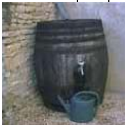
Citerne de récupération des eaux pluviales
