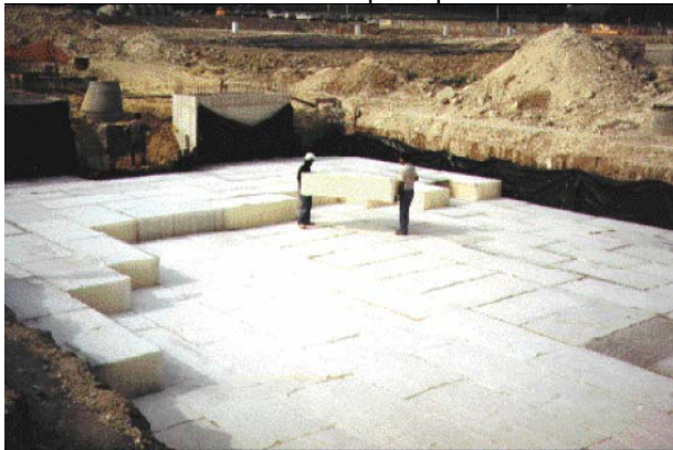
Chantier NIDAPLAST. Voie d'accès au lycée de Beaumont / Oise (95). Volume de stockage ~550 m 3 .
