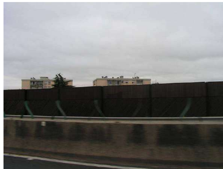
Mur antibruit de la RN 10 dans la traversée de Rambouillet (quartier de la Louvière)
