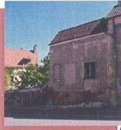
Corps de bâtiment : dénaturé.
