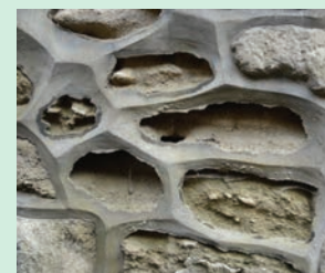
Pathologie : La mise en œuvre d'un joint ciment et le décapage de la pierre non prévue pour être mise à jour a entraîné une dégradation importante de la façade
