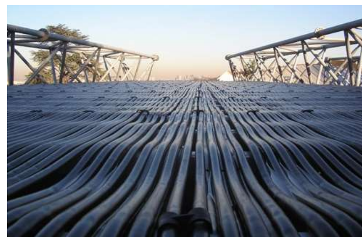
Le recours aux dispositifs solaires à Marly – ici toiture de la piscine recouverte d'une installation de panneaux solaires (moquette solaire).
