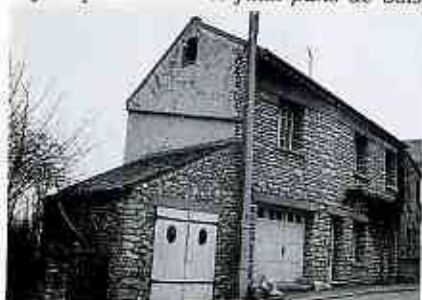
les linteaux en saillie sur la façade, les joints en creux ou en saillie,
