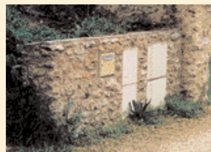
▲ Lors de la conception des clôtures il faut prévoir l'intégration des équipements techniques. On peut aussi placer les coffrets, en retrait dans le mur, derrière un portillon en bois en façade.
