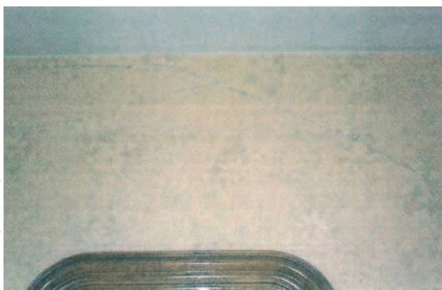
Fissuration intérieure, tapisserie déchirée - Maison André.
