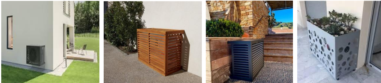
Exemples de caches permettant de dissimuler le bloc de climatisation
