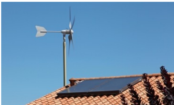
Exemple d'éolienne sur toiture (© Engie)
