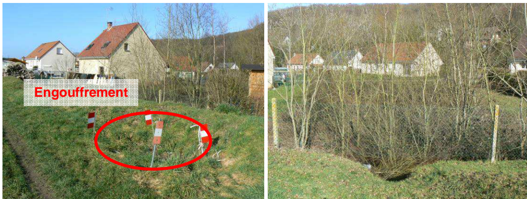
Merlon, engouffrements et bassin tampon
