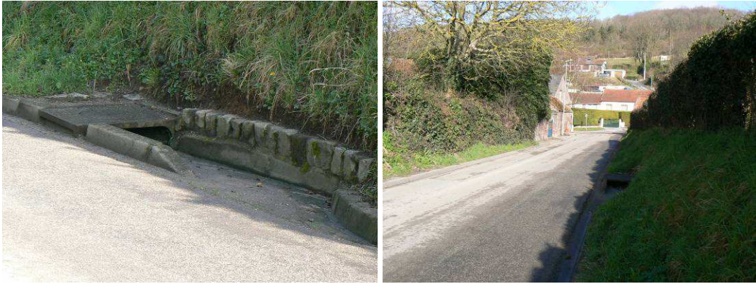
Avaloirs en aval de la rue de l'Egalité
