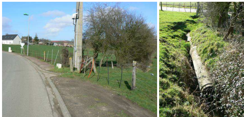
Saignée dans le trottoir et érosion marquée en aval
