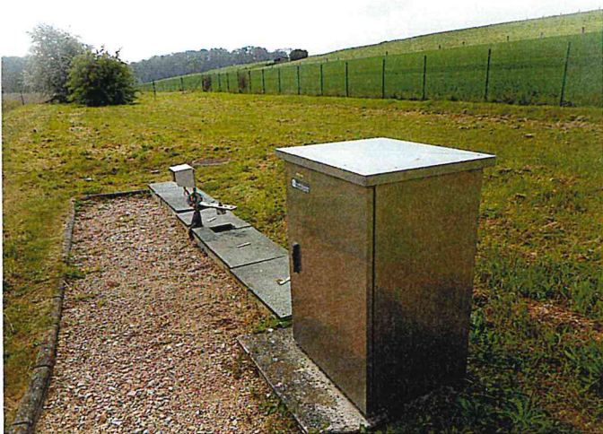
Canal de comptage de sortie
