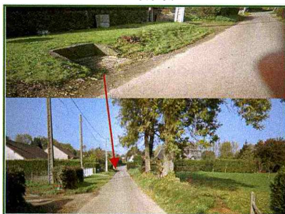
Béttoire gérant les eaux de la voie communale. L'habitation voisine est menacée lorsque la béttoire est saturée
