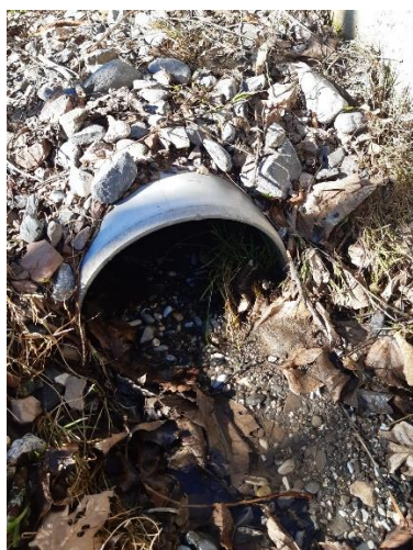
Photographie 9. Vue d'une canalisation partiellement obstruée (Verchaix Haut)
