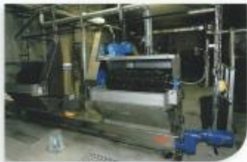
Les dégrilleurs débarrassent l'effluent des petits déchets et corps flottants contenus dans les eaux usées.
