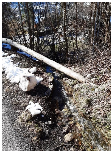
Photographie 4. Exutoire du réseau superficiel rue de Cossin (Verchaix Haut)
