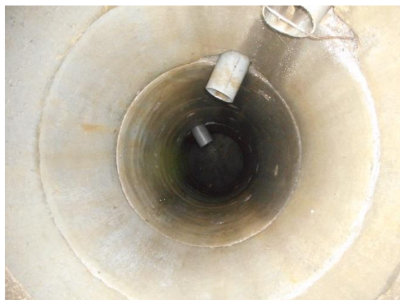
Photographie 15. Vue d'un puits d'infiltration route du Giffre (Sud-Est de la commune)
