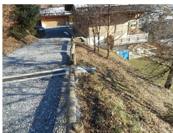
Photographie 6. Deuxième vue d'un rejet de gouttière (Verchaix Haut)
