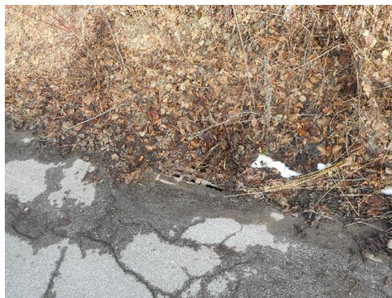
Photographie 8. Vue 2 d'un grille avaloir obstruée (Verchaix Haut)
