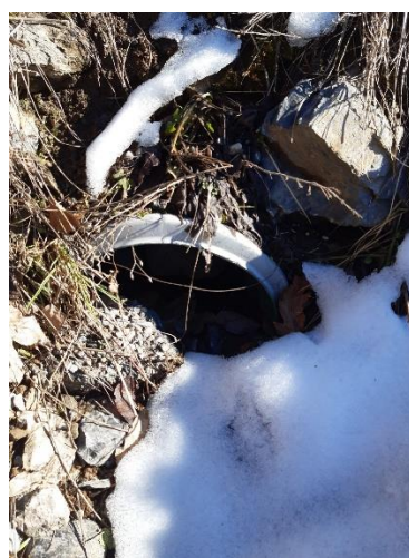
Photographie 10. Vue 2 d'une canalisation partiellement obstruée (Verchaix Haut)
