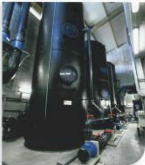
Air collecté dans la station traverse ces tours de lavage qui suppriment les odeurs qu'il peut contenir.
