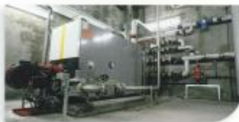
Alimentée avec du biogaz, la chaudière produit une chaleur utilisée sur place, pour le process et le chauffage des locaux.
