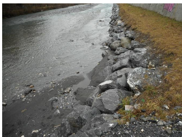
Photographie 13. Exutoire du réseau superficiel au niveau de la salle communale (Verchaix Bas)
