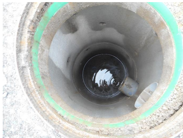
Photographie 16. Vue d'un puits d'infiltration rue de la Tataz (Sud-Ouest de la commune)
