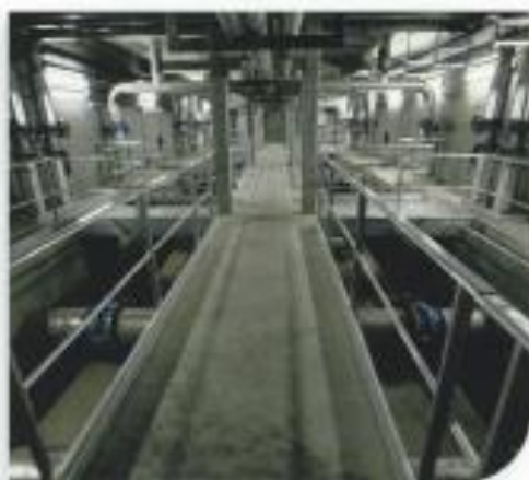
L'effluent pénètre dans le BioStyr®, en partie basse, la pollution dissoute y sera dégradée et transformée en boue par les bactéries.
