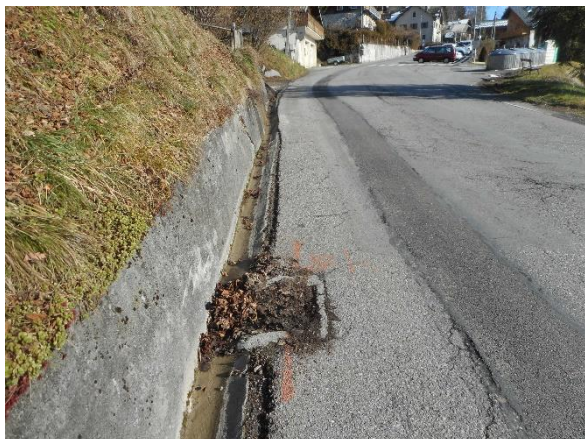
Photographie 7. Vue 1 d'un grille avaloir obstruée (Verchaix Haut)
