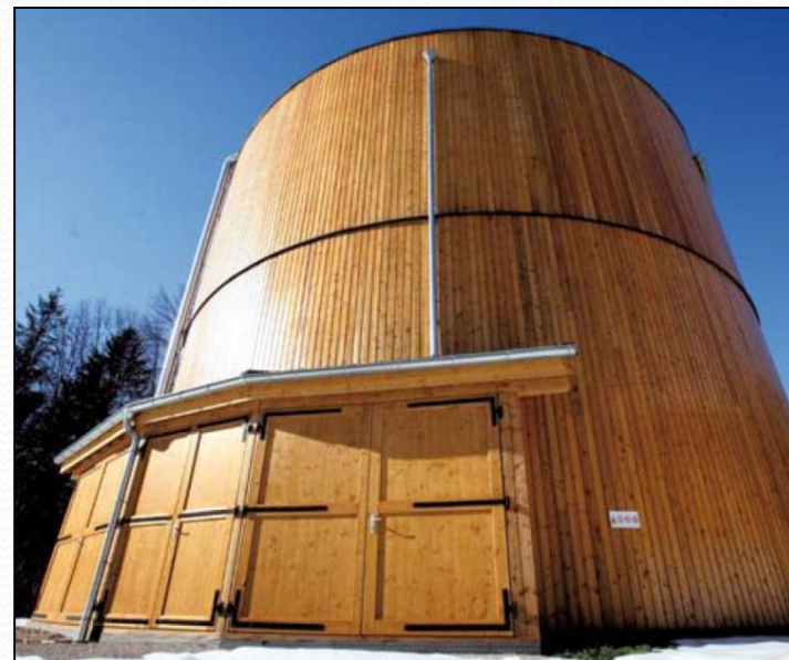
Silo de digestion des boues source: SIVOM MSSV
