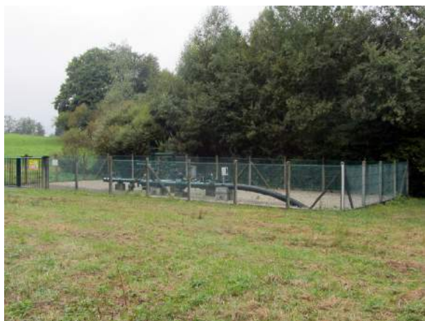
Poste de gaz à du Beulet
