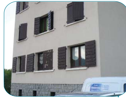
Appauvrissement de la façade dû à l'isolation par l'extérieur: décrochement, bavettes métalliques remplaçant les appuis de fenêtres.
