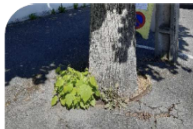
Par manque de place, les racines font éclater l'enrobé pour se développer.
