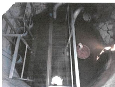
Bâche de refoulement mélange 2 puits
