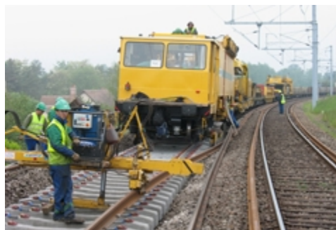
Longs Rails soudés sur traverses béton
