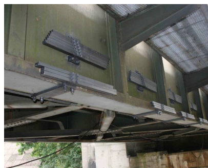
Absorbeur sur platelage
