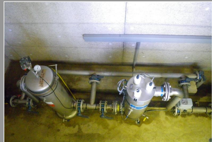
Traitement par filtration et UV à la station de traitement de Chavannes
