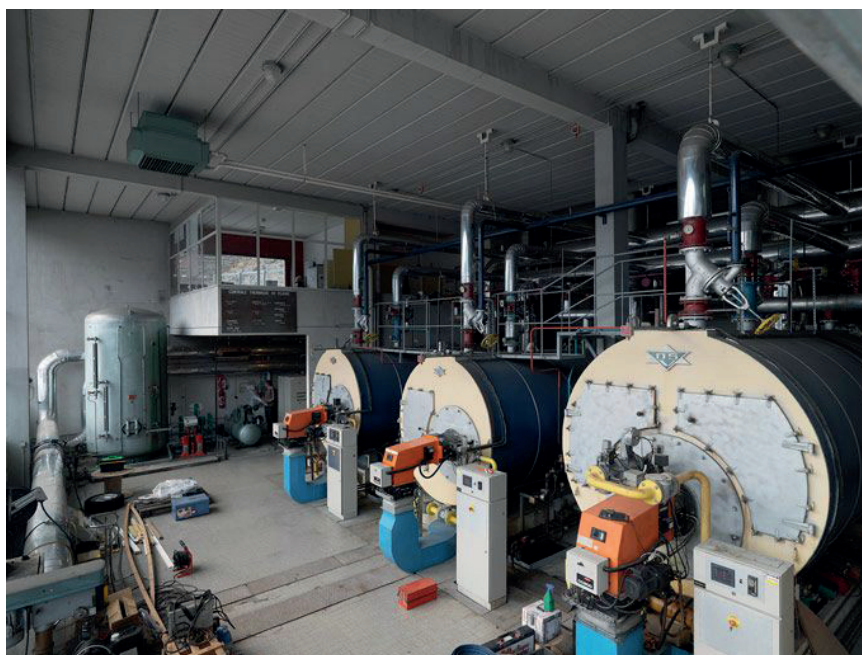
Chaufferie de Flaine - Source : Eric Dessert
