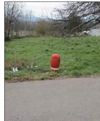
Poteau d'Incendie AN-3 situé à Andilly
