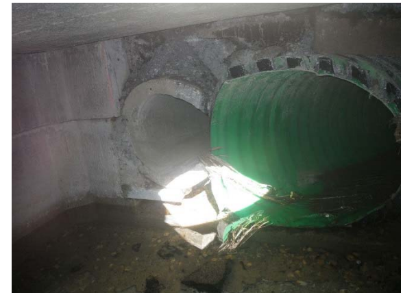
Evacuation des eaux
