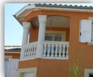
Type de balustres interdites
