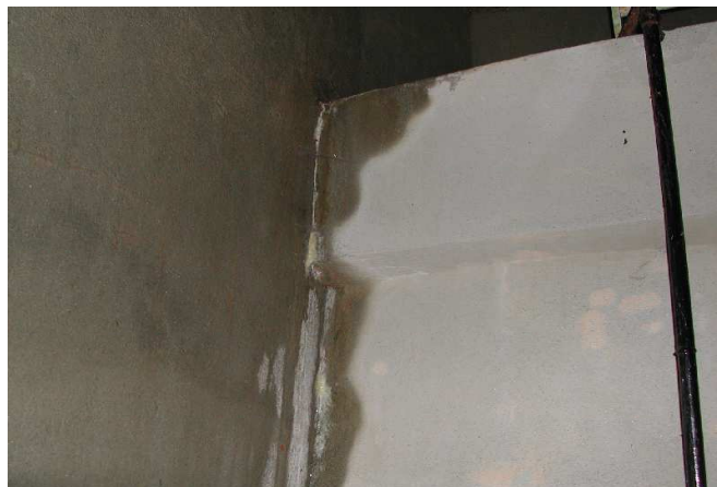
traces d'humidité - infiltrations
