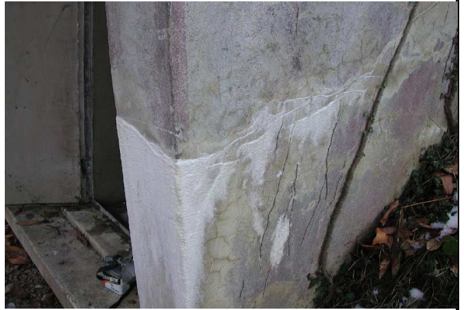
fissure mur extérieur
