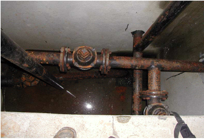
aperçut chambre de vannes
