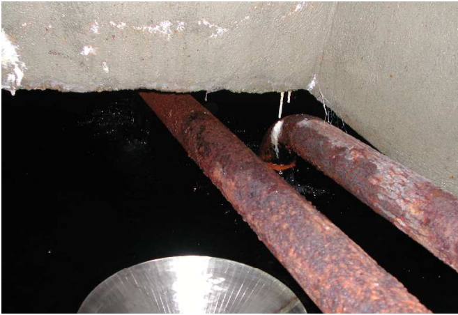
conduites d'alimentation du réservoir
