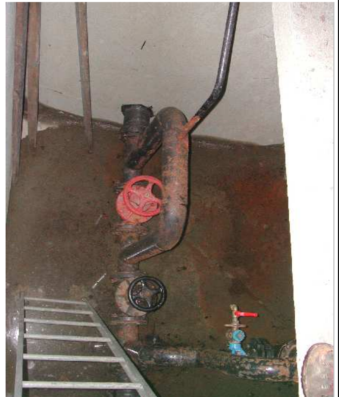
chambre de vannes - réserve incendie
